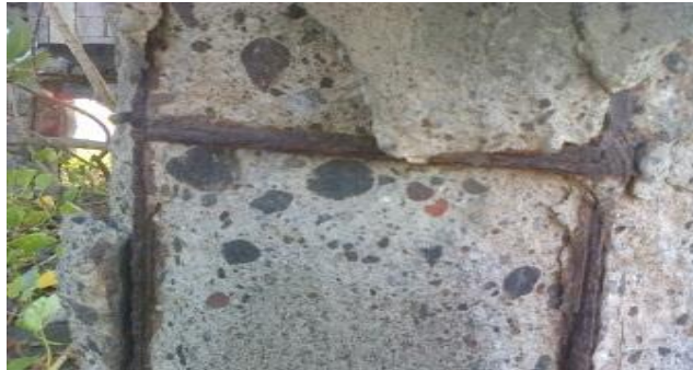
Figura 2. Corrosión y fractura en estructuras de concreto, igual al caso anterior. En el mismo lugar. Fuente: elaboración propia.
