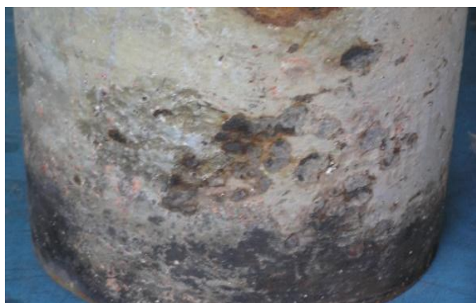
Figura 4. Corrosión combinada, uniforme y por picaduras, en una tubería de acero al carbono para conducción de agua en contacto con el suelo húmedo. Fuente: Archivos SIE-INDESA, 2019.
