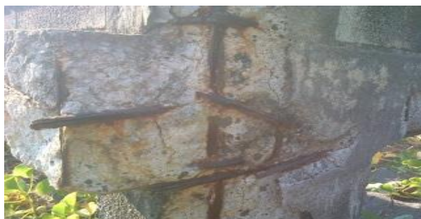
Figura 1. Corrosión y fractura en estructuras de concreto, en la playa “El Paredón Buena Vista”, Sipacate, Escuintla. Fuente: elaboración propia.
